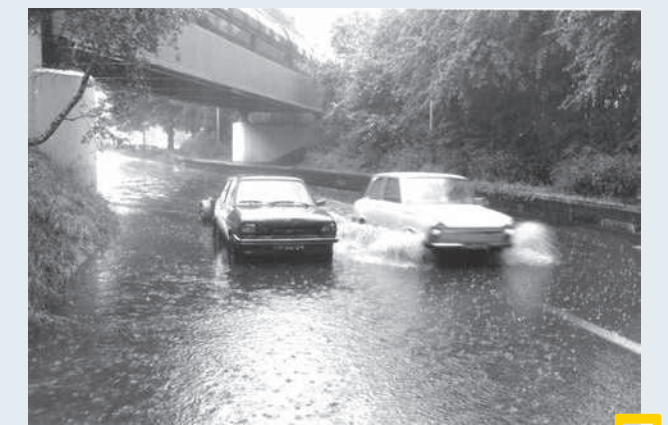
Bij forse regenval veranderde het viaduct in een autowasstraat
